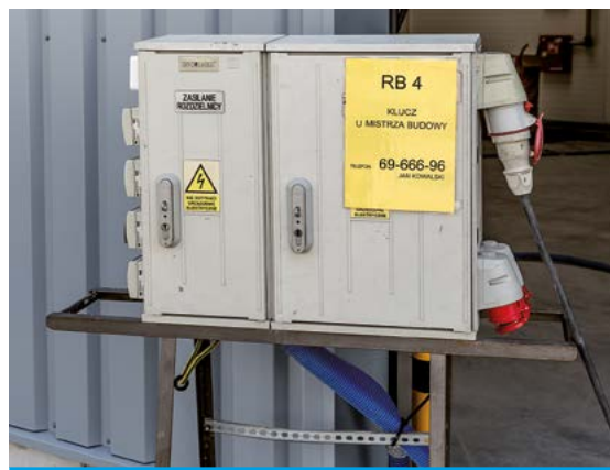
Rozdzielnica zabezpieczona przed dostępem osób nieuprawnionych.
